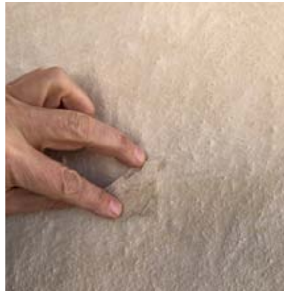
Färgskillnaden är nästan obefintlig mellan ny och ursprunglig puts.
